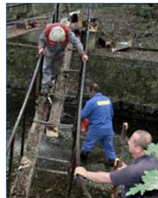
■ Lávka přes Červený potok musela být kvůli havarijnímu stavu odstraněna. 2x foto: var
